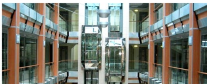
Проектирование и монтаж системы бесперебойного энергоснабжения лифтового оборудования бизнес-центра на базе ИБП и БКН ИМПУЛЬС.
